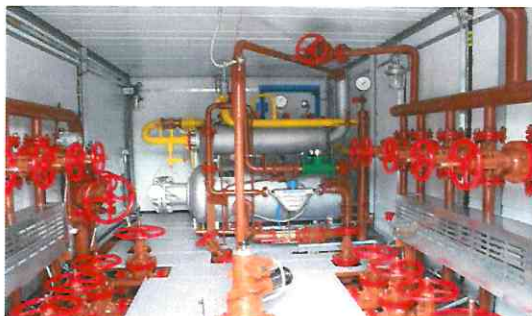
Рисунок 4 - Внешний вид оборудования БТ многоскважинной установки
