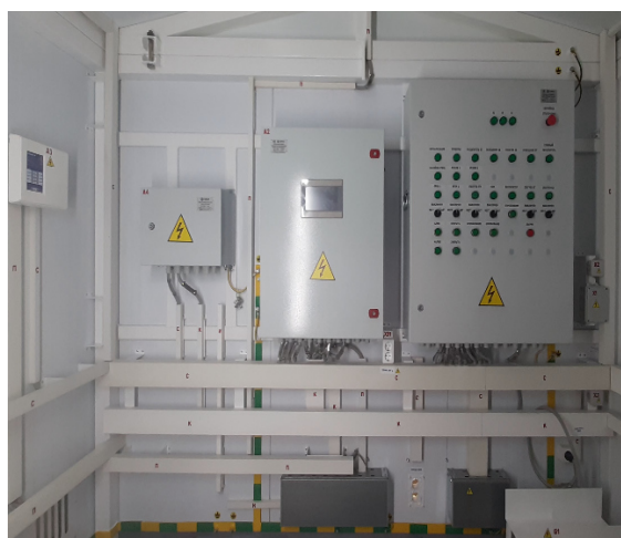
Рисунок 2 - Внешний вид оборудования БА общепромышленного исполнения
